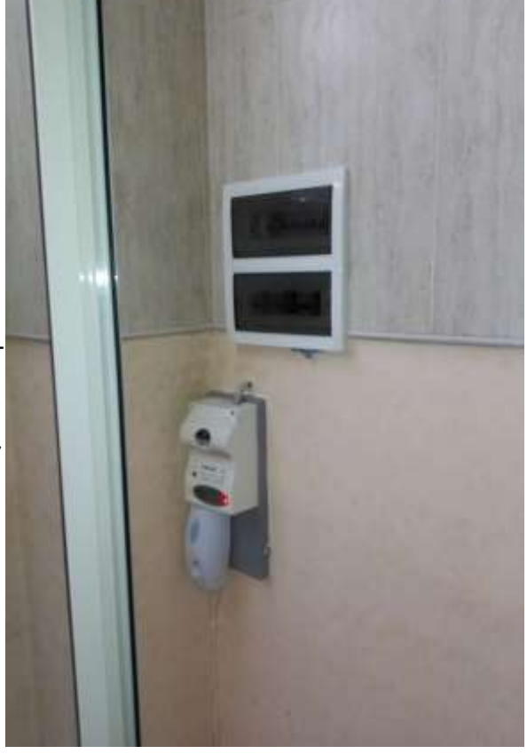
Foto interna ambiente 1 – Quadro Impianto elettrico
